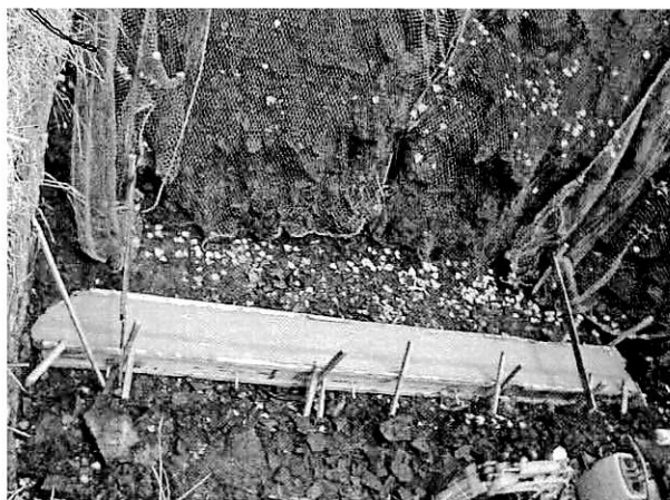
「基礎コンクリート工」 仮設安全ネットの奥に、地山を構成する「角礫」が見えている。
