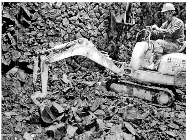
「崩落石掘削状況」 崩落土砂は角礫（角の尖った崩落岩）で構成されている。
